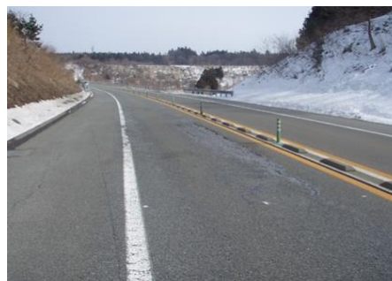
【路面損傷状況】
