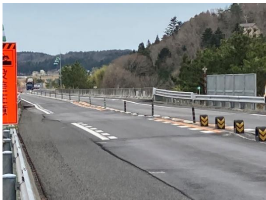
舗装の段差状況(1)
