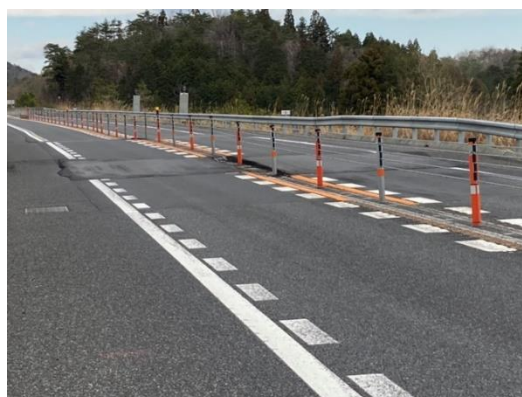
舗装の段差状況(2)
