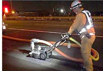
路面標示消去状況
