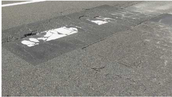
舗装損傷状況
