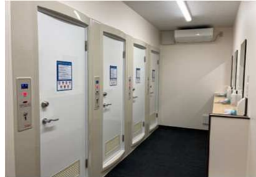
シャワー設備
