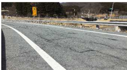
舗装損傷状況 現状
