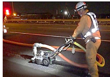
路面標示消去状況
