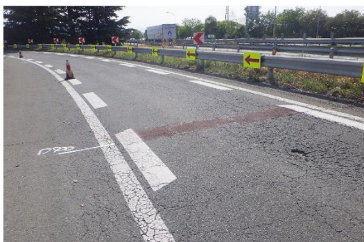
舗装損傷状況
