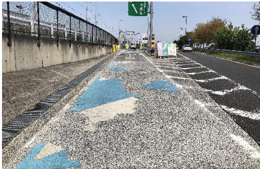
路面損傷状況
