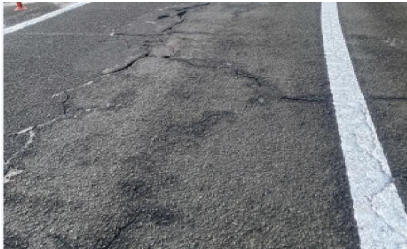
舗装路面損傷状況
