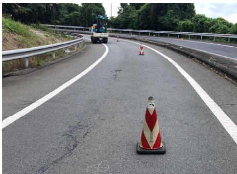
舗装損傷状況
