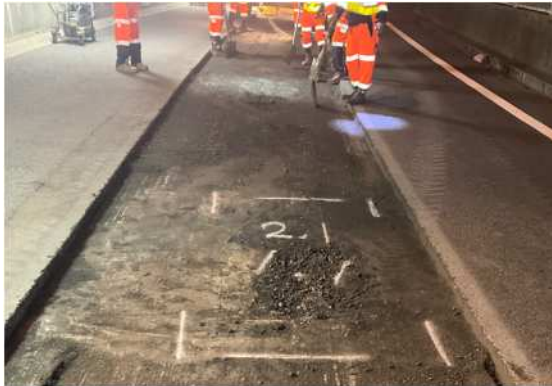
床版損傷状況
