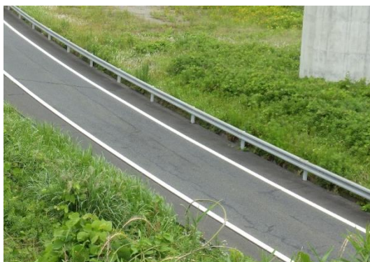
舗装損傷状況
