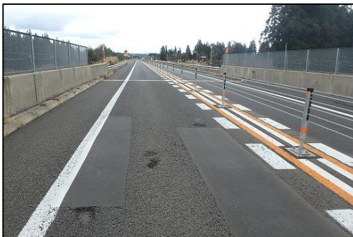
舗装損傷写真
