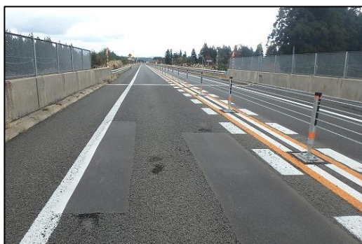
舗装損傷写真
