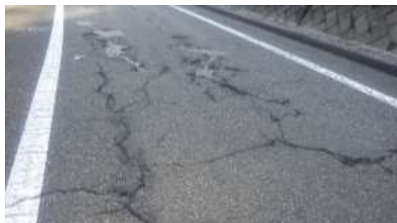
舗装損傷状況
