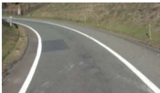
舗装損傷状況
