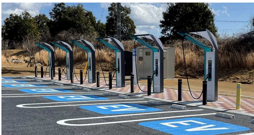
写真-1 マルチコネクタタイプ(6口)EV 急速充電器 (浜松SA(下り線))
