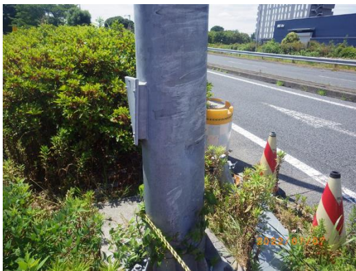
鹿沼IC出口ランプ 標識支柱損傷状況
