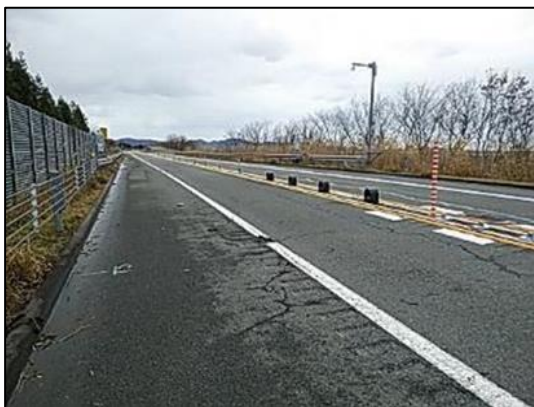
舗装損傷写真
