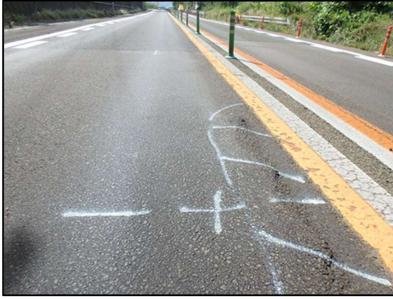
舗装損傷写真
