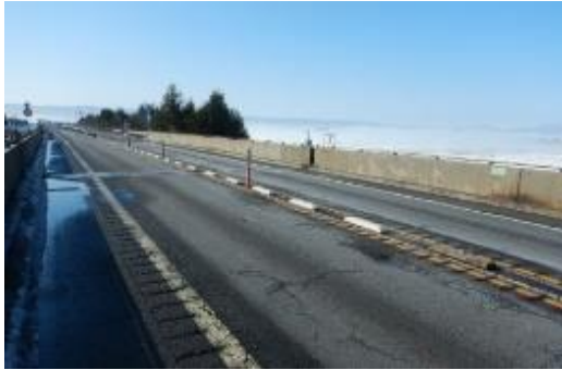
損傷した路面状況
