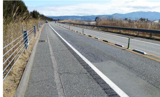
損傷した路面状況
