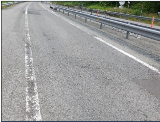
舗装損傷写真
