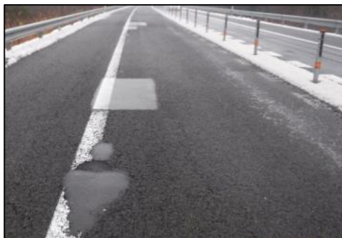
舗装損傷写真
