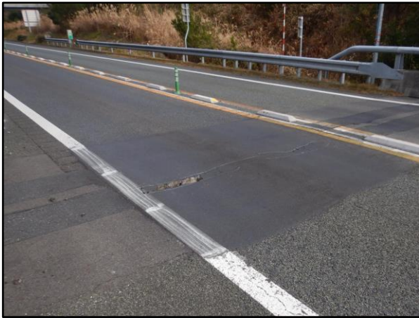
舗装損傷写真
