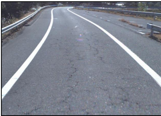
舗装損傷状況
