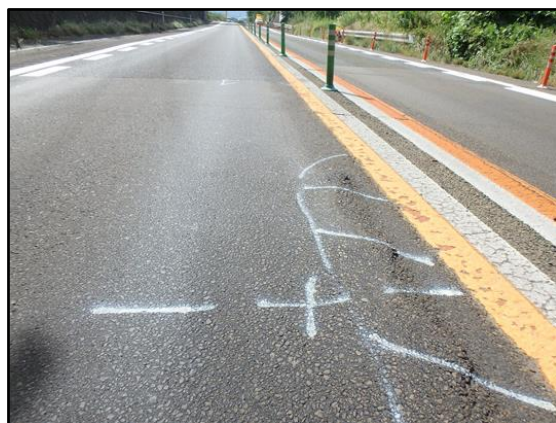
舗装損傷写真
