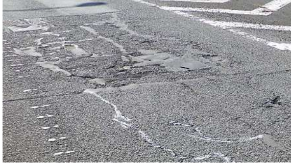
舗装損傷状況
