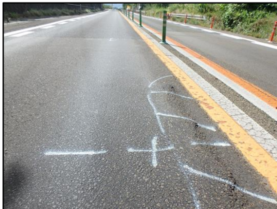
舗装損傷写真
