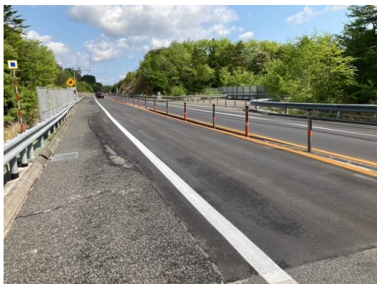
舗装損傷写真
