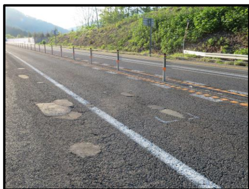
舗装損傷写真
