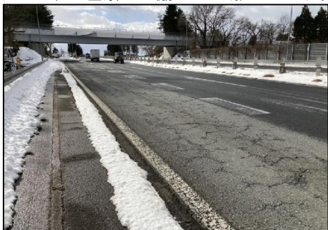
舗装損傷状況
