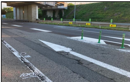
舗装損傷状況
