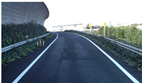
舗装損傷状況
