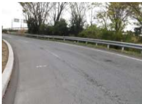
舗装損傷状況
