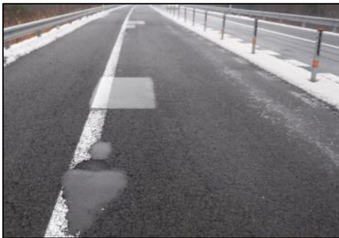
舗装損傷写真
