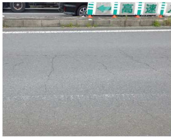
舗装損傷状況②
