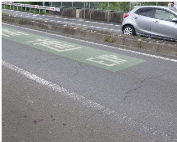
舗装損傷状況①
