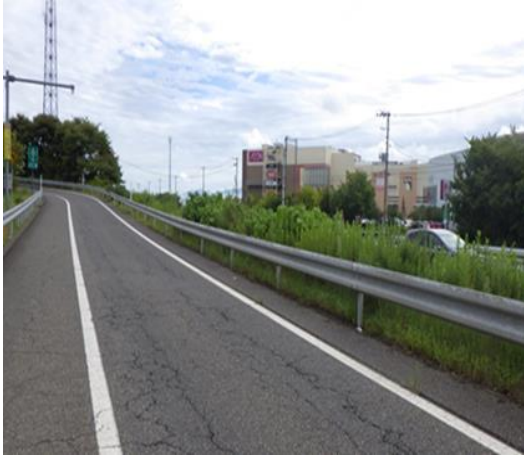
舗装損傷状況
