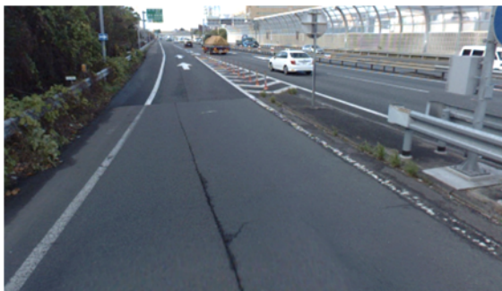
舗装損傷状況
