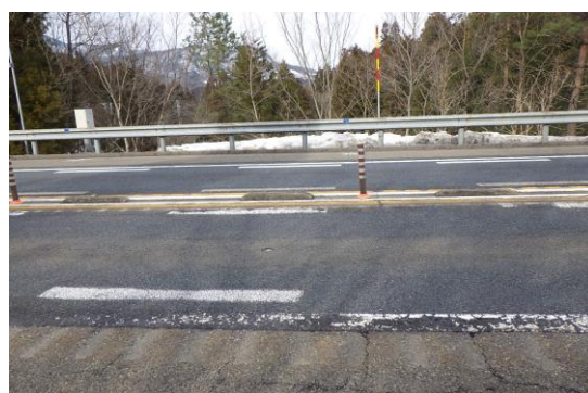
損傷した路面状況
