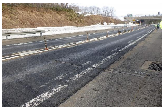
損傷した路面状況
