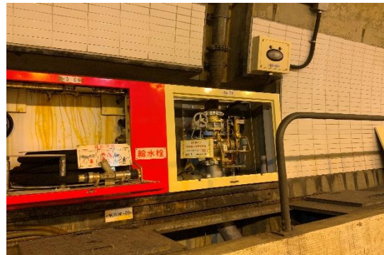
非常用設備更新
