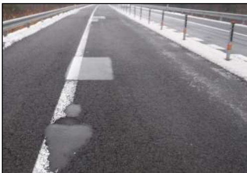
舗装損傷写真
