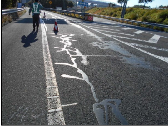
舗装損傷写真
