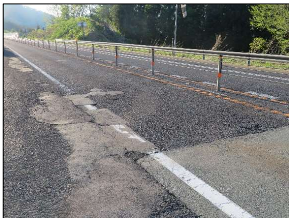
舗装損傷写真
