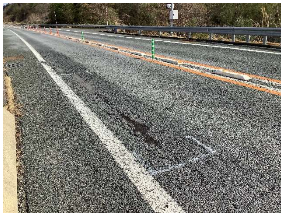
舗装損傷写真
