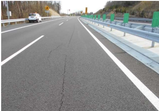
舗装損傷写真
