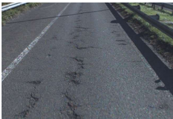
舗装損傷状況
