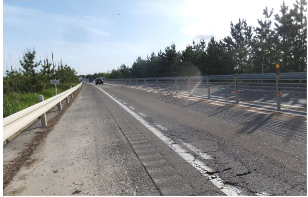
損傷した路面状況
