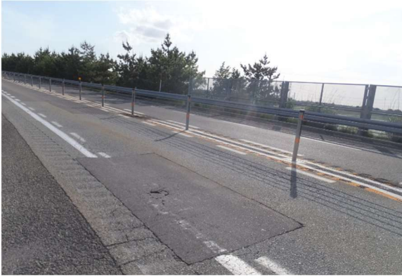
損傷した路面状況
