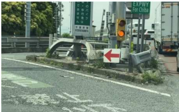
事故損傷状況
