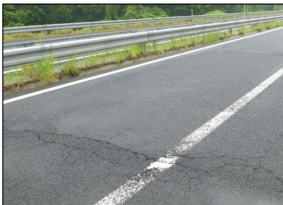
舗装損傷写真
