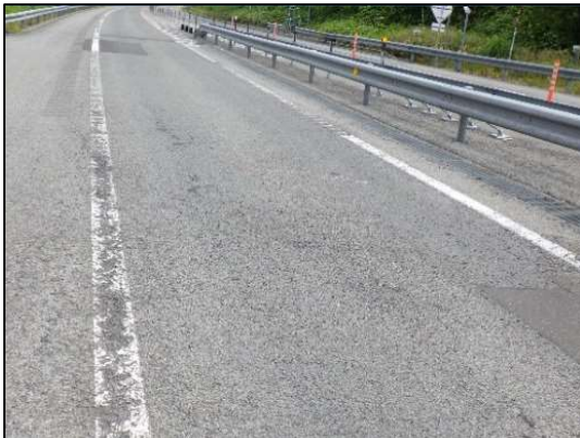
舗装損傷写真
